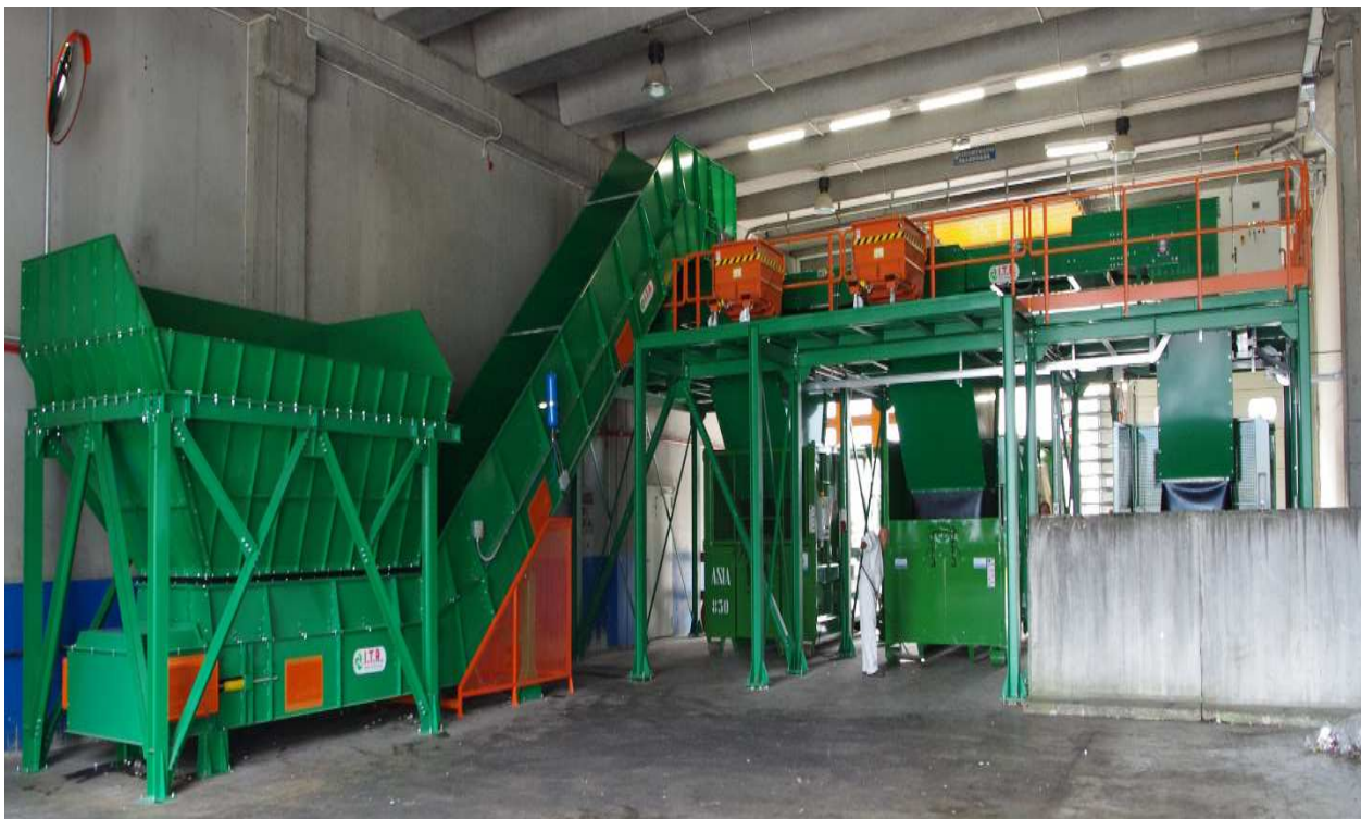
Figura 1 - Impianto di selezione manuale spinta degli imballaggi misti
